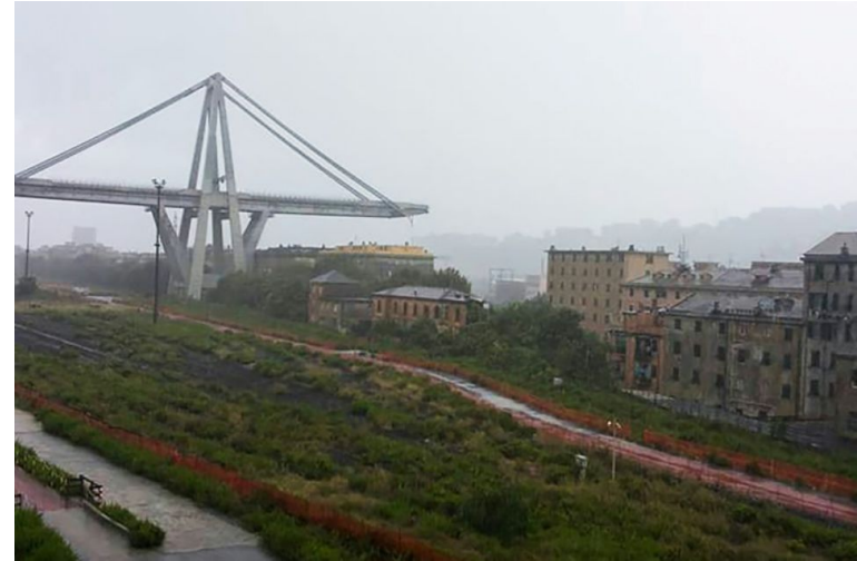
FIGURE 16 – Portion du viaduc de l'A10 écroulée à Gênes en Italie, le 14 août 2018 suite à une tempête Photo Paola PIRRERA. AFP
